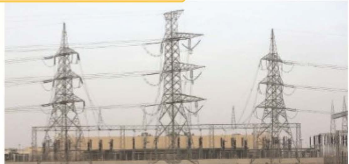
محطة سدير لتحويل الكهرباء
