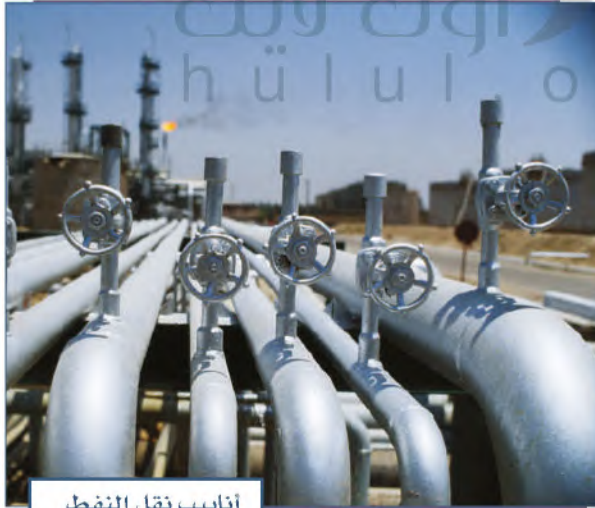
أنابيب نقل النفط
